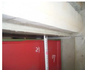
躯体と鉄骨との隙間
